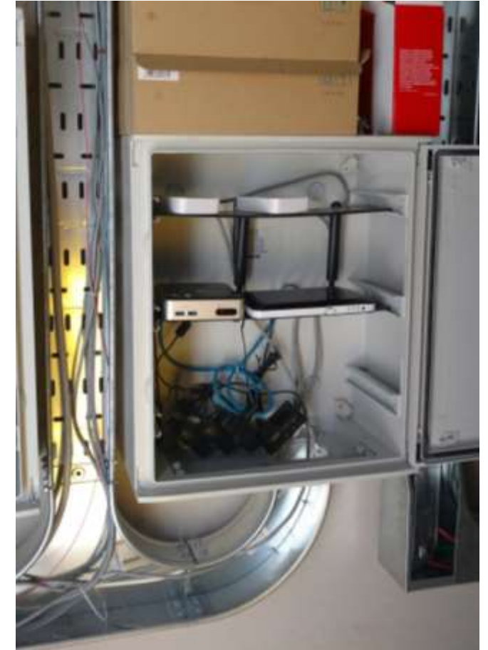
NUC installato nel locale tecnico che ospita i servizi BMS
